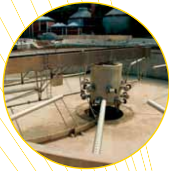
Rundräumer im Nachklärbecken und getauchte Ablaufrohre
