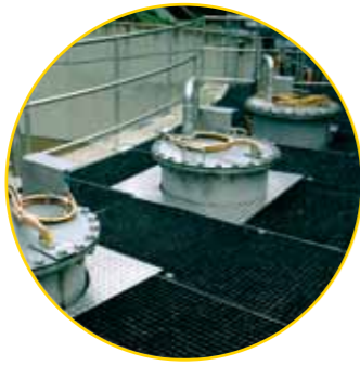
Drei Rohrschachtpumpen DN 800
