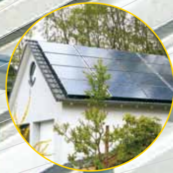
Photovoltaikanlage auf einer Garage
